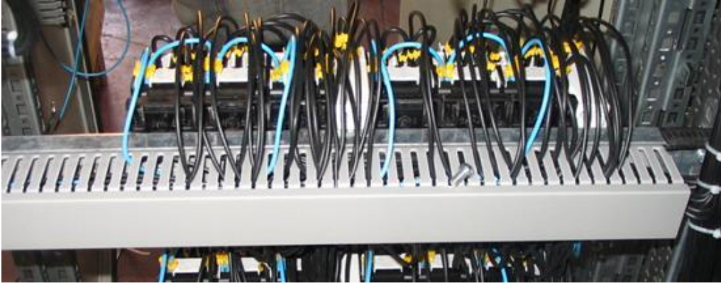
Resim 4.2: Kanal içine yerleştirilme işlemi tamamlanmış kablolar
